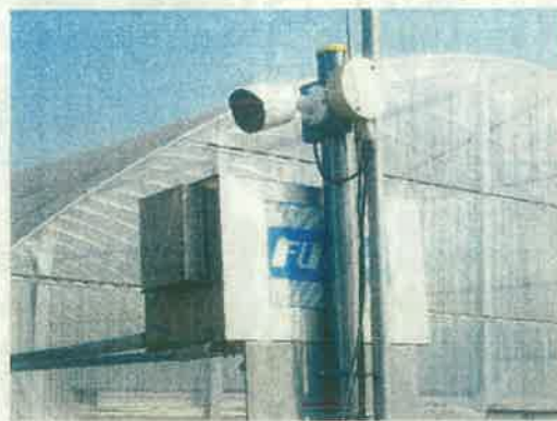
防犯カメラの設置
