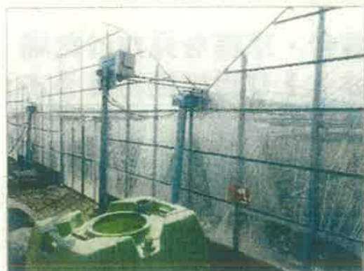
防犯カメラの設置
