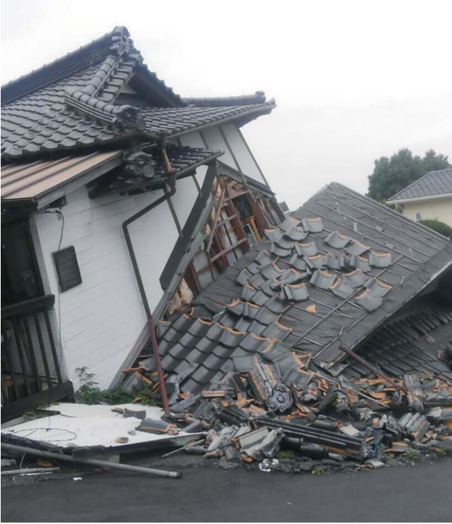
倒壊した家屋(熊本県益城町)
