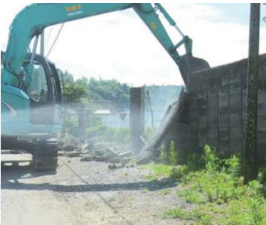
春富中プール ブロック塀撤去工事 【写真提供:伊那ケーブルテレビジョン(株)】
