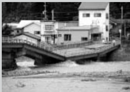
橋脚が傾き落下した殿島橋
