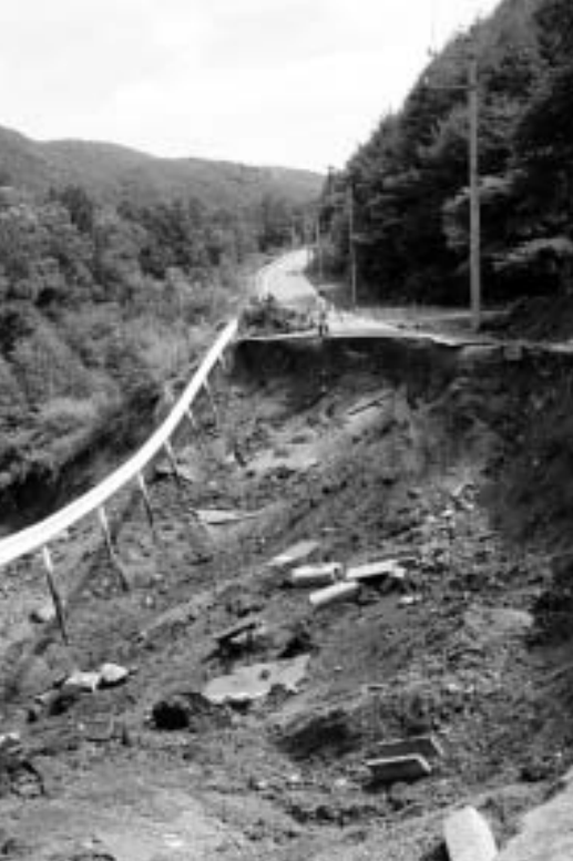
県道中山松倉線の大崩落
