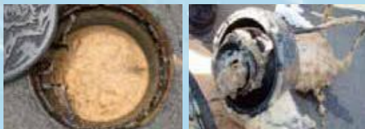
油で詰まった マンホールの内部
