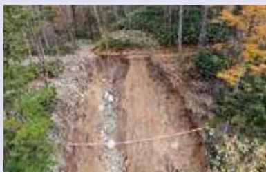
豪雨により崩落した水路と法面
