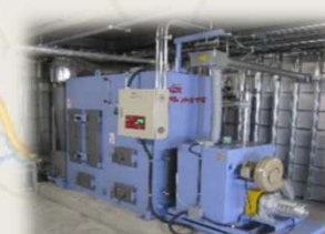
ペレットボイラー（給湯）
