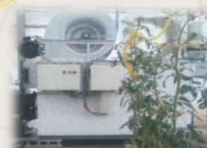
ペレットボイラー（温風）
