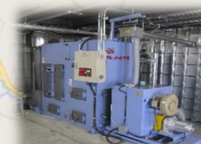
ペレットボイラー (給湯)
