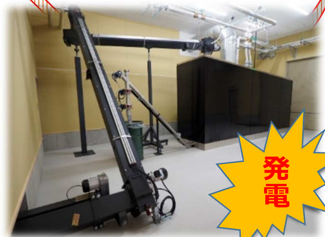
④機械室（発電機）
