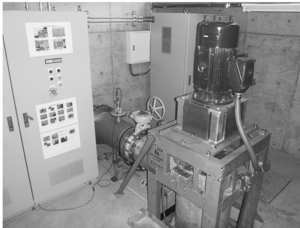
美和土地改良区 (最大出力12.2kW、26世帯分)
