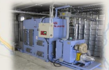
ペレットボイラー (給湯)
