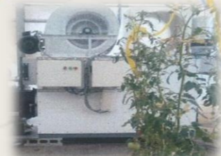
ペレットボイラー (温風)
