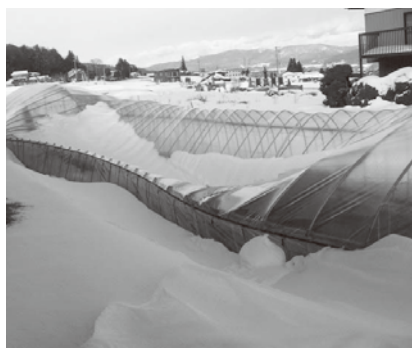
倒壊したビニールハウス
