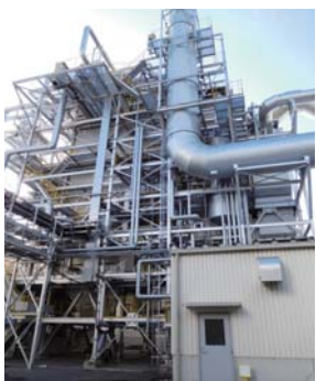
バイオマス発電所
