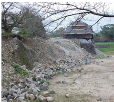
熊本城の崩れた城壁
