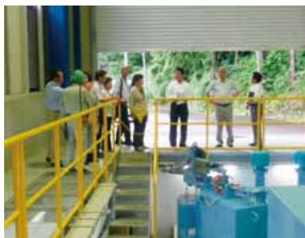
全国初の市民出資による小水力発電所
