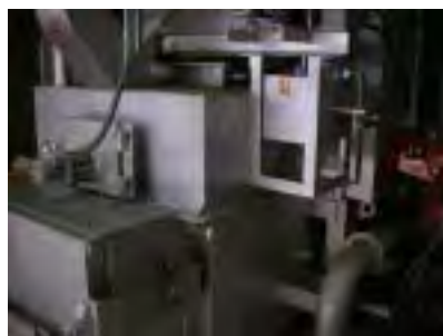
ペレットボイラ（森林観光センター）
