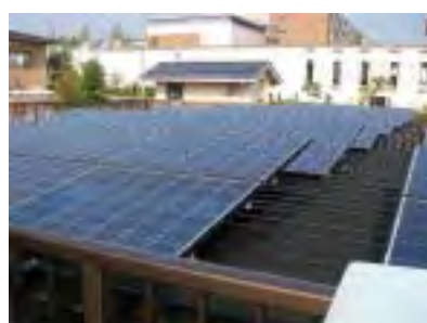
太陽光パネル
