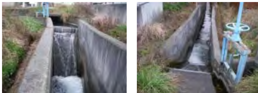
図 6.13 小水力発電の設置位置の現況(富県地区)
