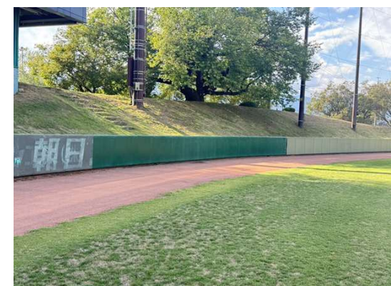
外野フェンス（修繕済部分）
